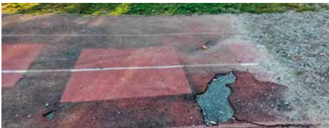
Der Sportplatz der Regenbogenschule ist schon seit langer Zeit in einem sehr schlechten Zustand, die Verletzungsgefahr hoch. Fotos: privat
